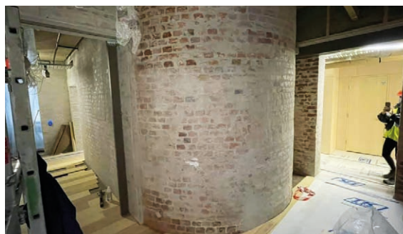
Bildet viser det som skal bli Fagpressens kontorer i Pressens hus, fra april 2021. De trykte bladene skal få flott eksponering i et utstillingsrigg på teglsteinsøylen midt i bildet. (Foto: Per Brikt Olsen).
